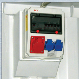
Verteilerkasten mit integrierten Steckdosen
